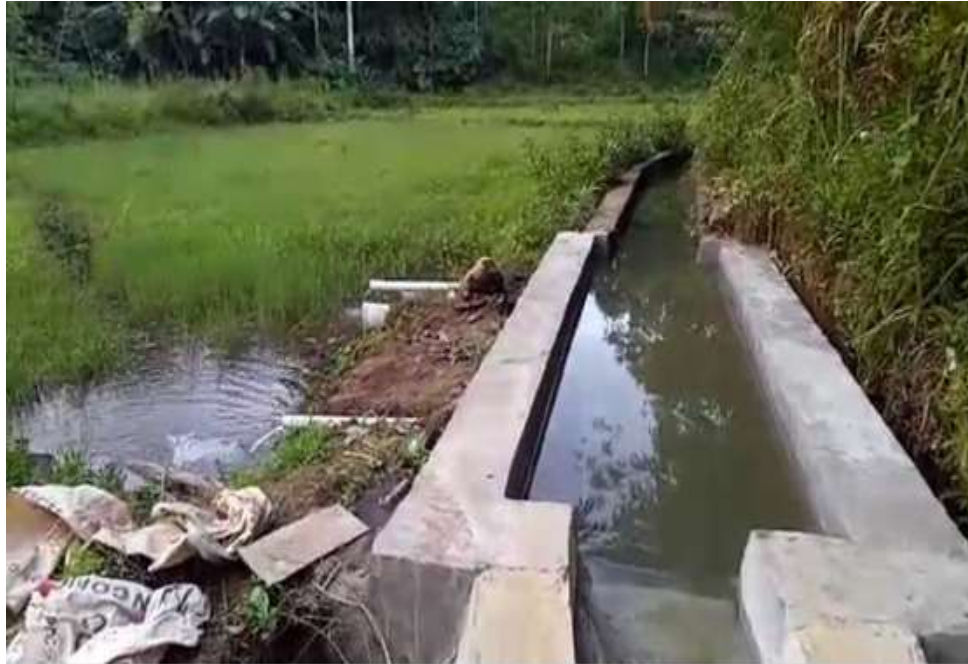
Gambar 3: Bangunan peninggi muka air dengan pemasangan 2 pipa outflow
